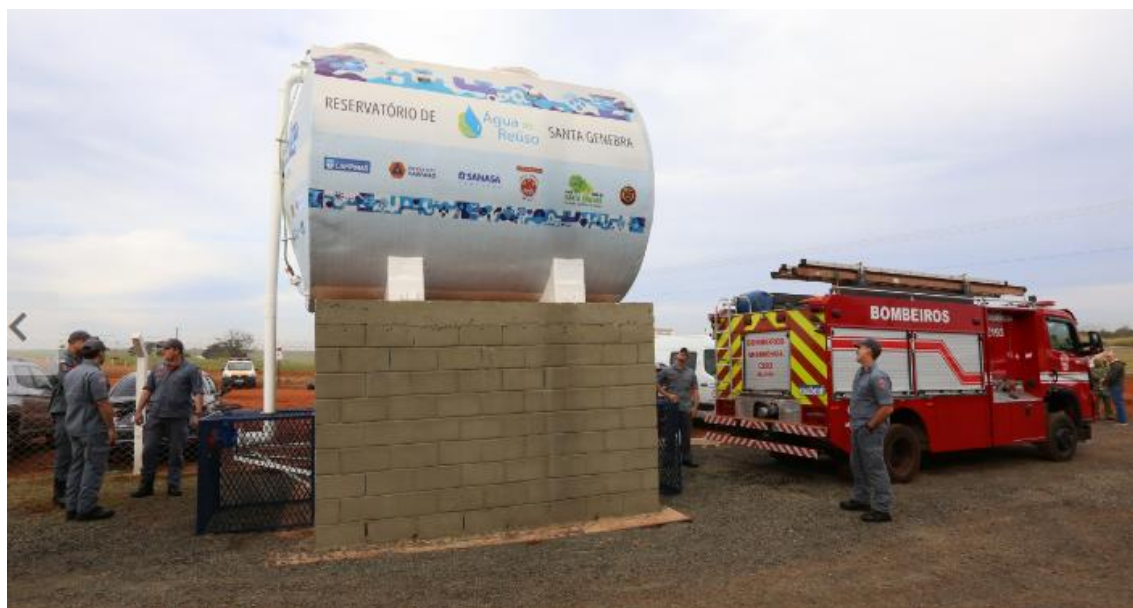
Figura 1 – Reservatório de água de reuso destinado ao apoio às ações de combate a incêndios na região da Mata de Santa Genebra, em Campinas/SP.
